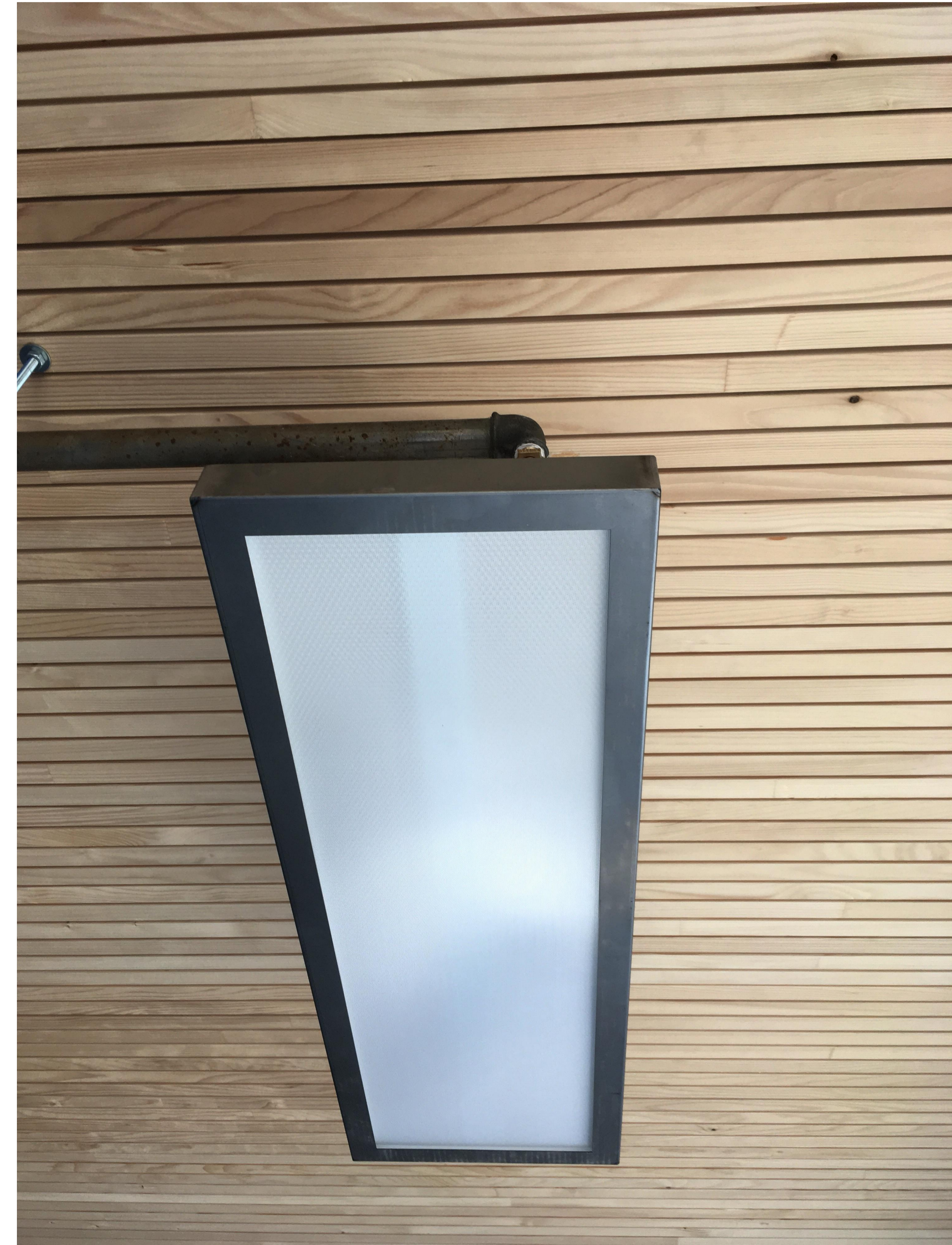
Brettstapeldecke, mit Akustikfräsungen
