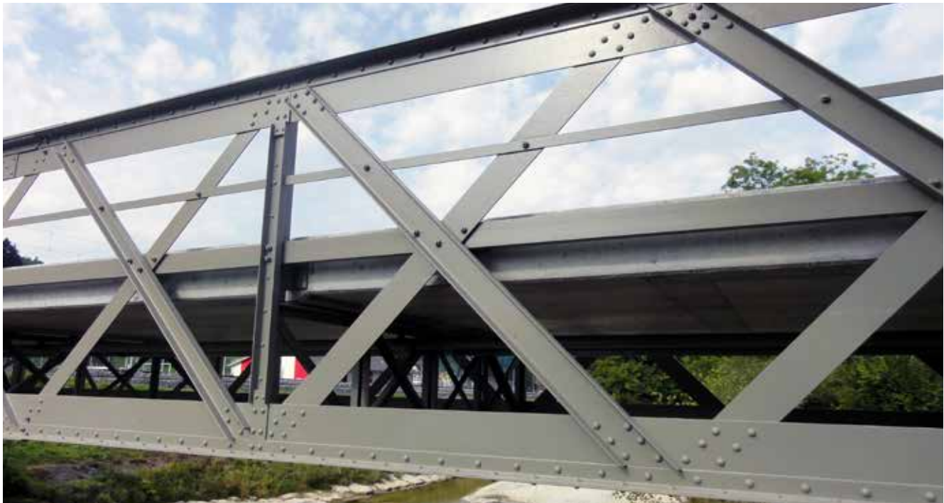
Für die Instandsetzung wurde die schicke Stahlfachwerkbrücke mit einem Kran aus der Verankerung gehoben (Bild unten) und in ein Stahlwerk transportiert.
