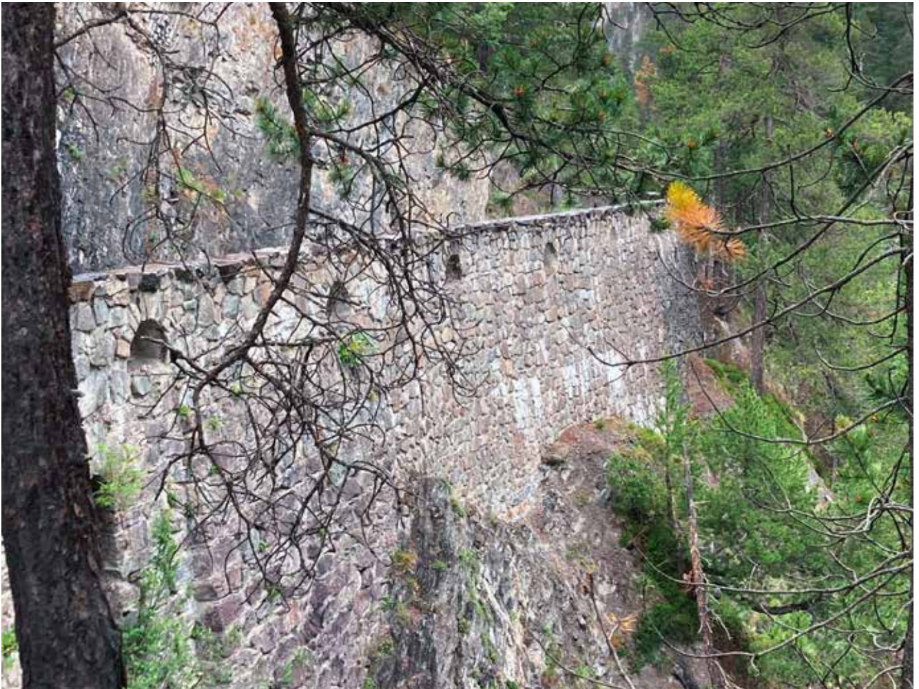
Die imposanten Kunstbauten, wie hier die am Fels stehenden Brüstungsmauern, machten es erst möglich, dass die Zügenschlucht befahren werden konnte und auch heute dem Langsamverkehr offen steht.
