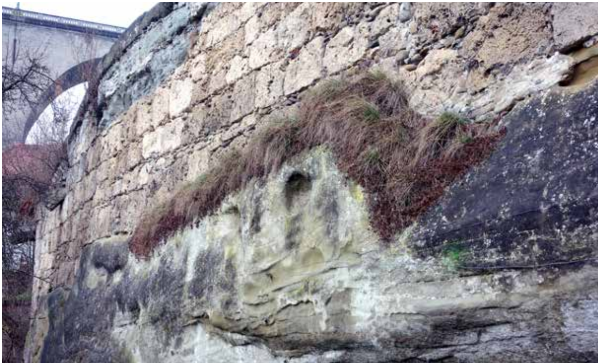
Wenn eine Mauer Geschichten erzählt ... Die Stützmauer der Route des Neigles macht die Erhaltungsmaßnahmen unterschiedlicher Epochen sicht- und erlebbar.
