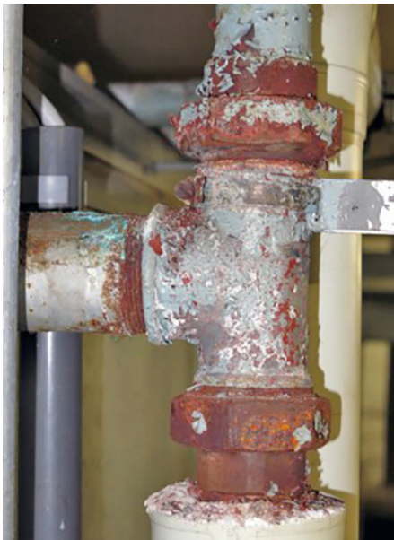
Alte und stark korrodierte Leitung
